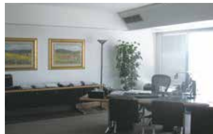
Một hệ thống thu hồi nhiệt VRV đã được lắp đặt ở hai tầng trên cùng ở khu vực có một số phòng cá nhân riêng.
